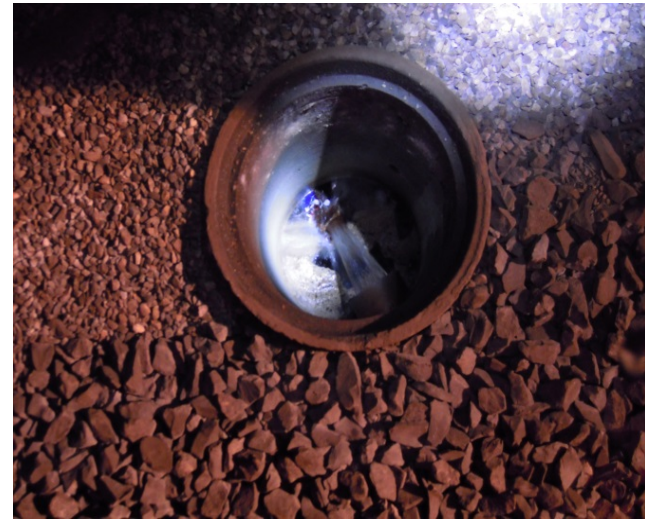
Kontrollschacht Bereich eingebrochene Mittelentwässerung
