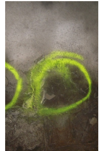
Markierung von Hohlstellen
