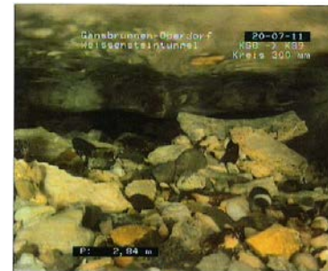
Foto: 16_3b, Videoband Nr.: DVD, 00:00:53 2.62m, Sedimentation (Geröll), Sohle, 20 %, Schadensanfang
