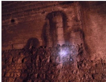
Wassereintritte am Gewölbe
