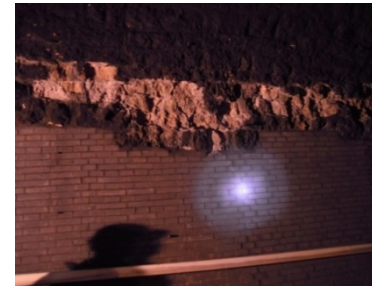
Abplatzungen infolge Druckgelenksbildung
