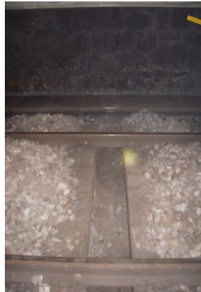
Ungenügende Schotterstärke / Schotter verschmutzt
