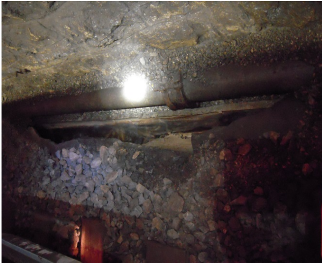
Écroulement de l'évacuation latérale des eaux
