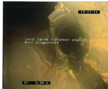
Foto: 29_2a, Videoband Nr.: DVD, 00:00:00 0m, Info: Keine Aufnahmen möglich Rohr eingedrückt
