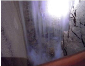
Source d'eau au niveau du parement
