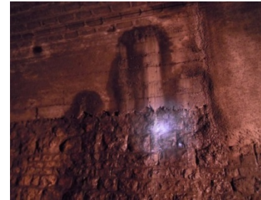
Infiltrations d'eau au niveau de la voûte
