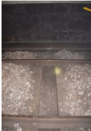
Épaisseur de ballast insuffisante / ballast sali
