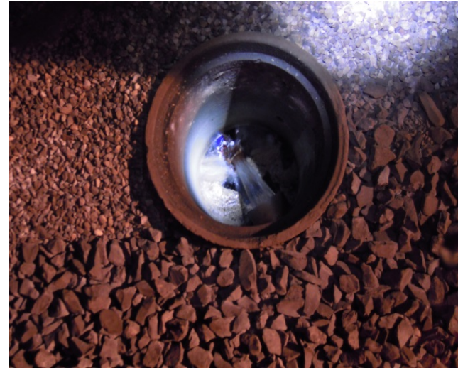
Regard au niveau de la zone d'évacuation centrale écroulée
