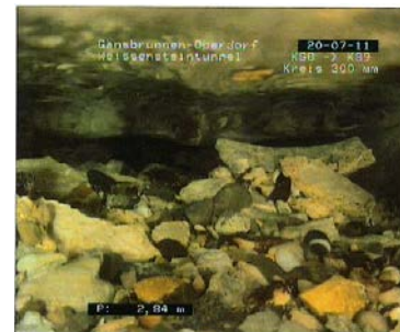
Foto: 16_3b, Videoband Nr.: DVD, 00:00:53 2.82m, Sedimentation (Geröll), Sohle, 20 %, Schadensanfang
