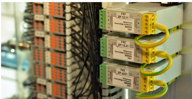
Abb. 59: Blitzschutz direkt am Anschlussgestell KAG
