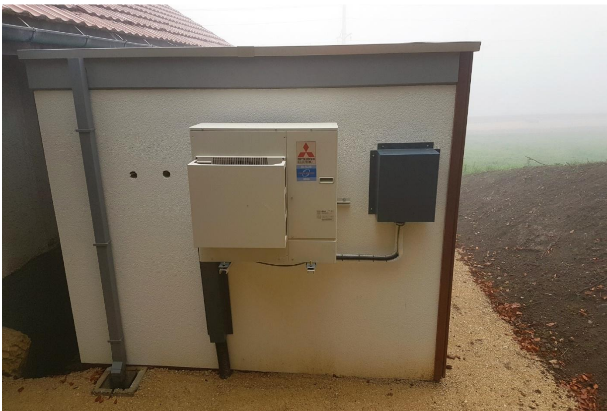
Abb. 48: Gebäude UF 3066 mit ESTW EUROLOCKING von hinten mit Klimaanlage
