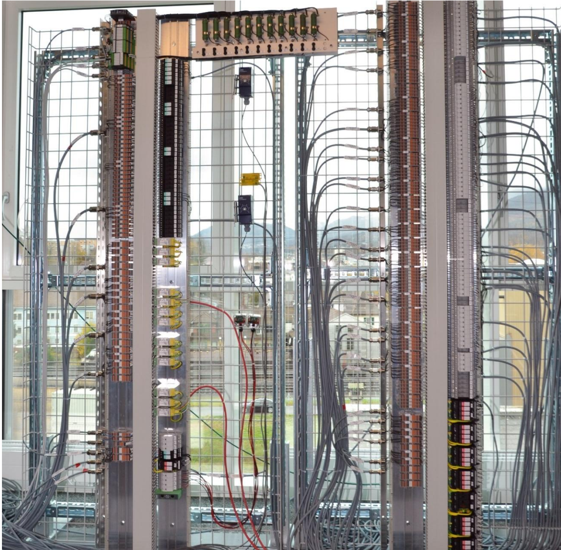
Abb. 58: Kabel-Anschlussgestell KAG mit Überspannungsschutz
