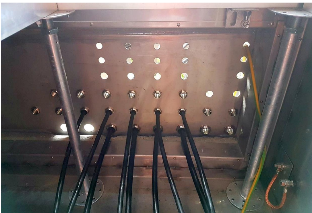
Fig. 57: Plaque d'entrée des câbles vue de l'intérieur du bâtiment
