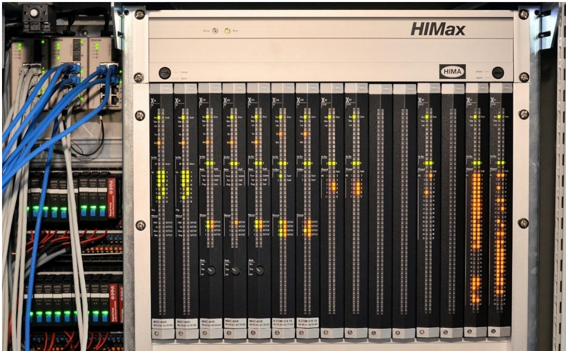
Fig. 15: Un Rack avec le calculateur central et les divers modules.
