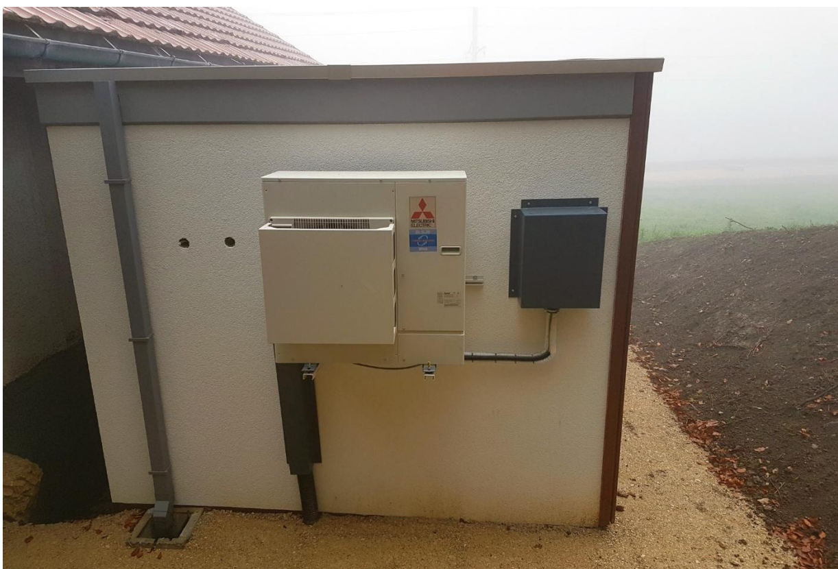
Fig. 48: Arrière du bâtiment UF 3066 avec le climatiseur
