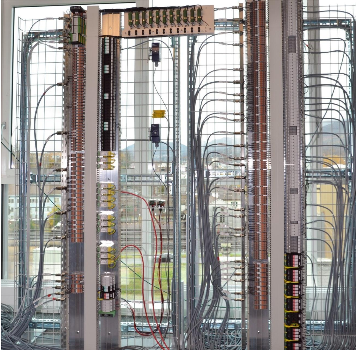
Fig. 58: Cadre de raccordement des câbles (KAG) avec protection contre les surtensions
