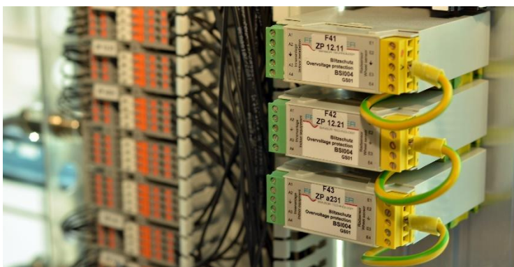
Fig. 59: Parafoudre directement sur la baie de raccordement KAG
