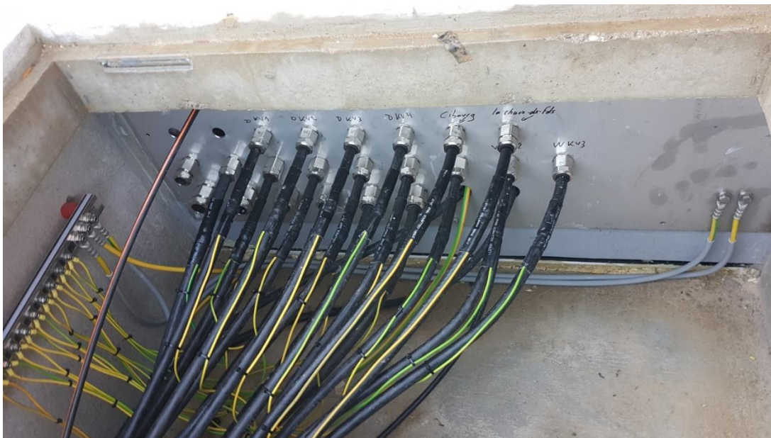
Fig. 56: Plaque d'entrée des câbles vue du puits à câbles
