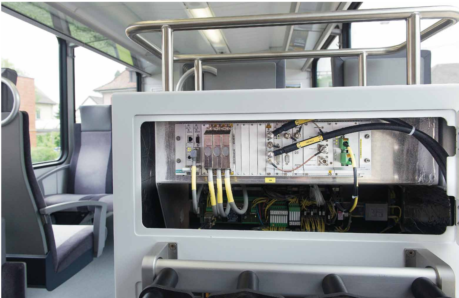
Faible encombrement de l'ordinateur ZSI 127 logé dans l'espace destiné aux voyageurs.
