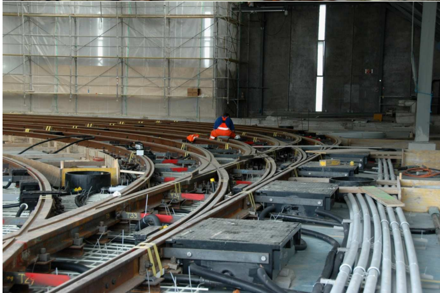
Nouveau peigne d'entrée au dépôt Klybeck (Photo M. Bossard).
