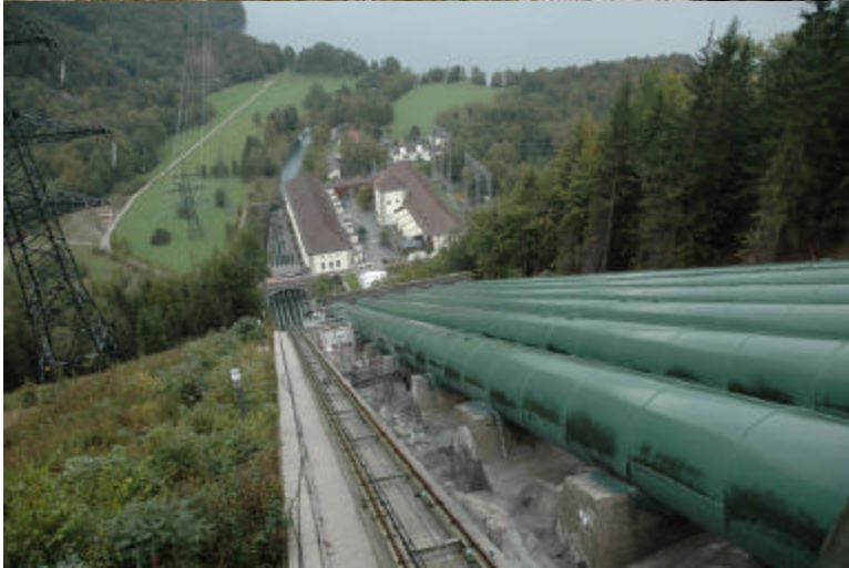
Das Kraftwerk Walchensee vom Wasserschloss aus gesehen (M. Bosshard).
