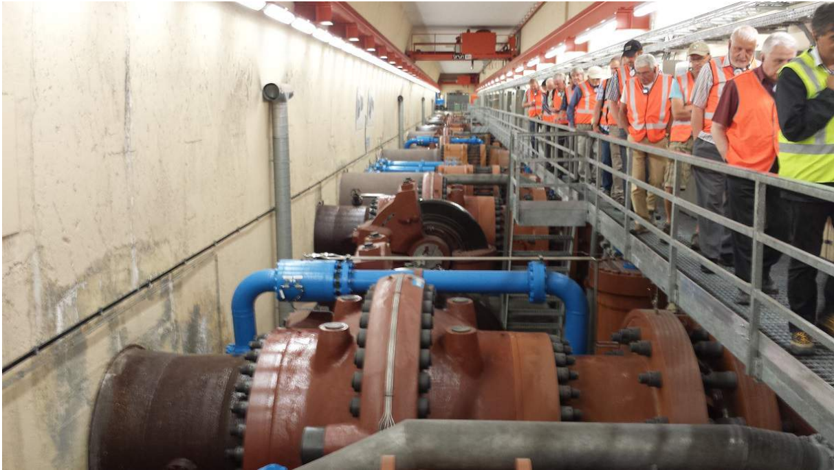
Unterirdische Kaverne des Kraftwerkes Grimsehl 2 mit den Rohrleitungen der vier Maschinengruppen, die sowohl als Generator wie als Pumpe verwendet werden können. Es handelt sich um das modernste der neun Kraftwerke der KWO.
