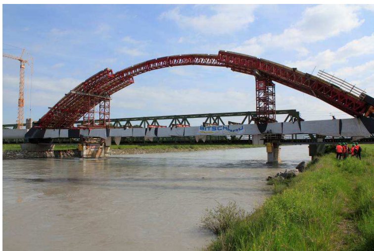
Die neue Rheinbrücke im Bau. Sie wird wesentlich höher liegen, um bei Hochwasser den Rhein nicht mehr zu stauen (Foto Th. Stolz).
