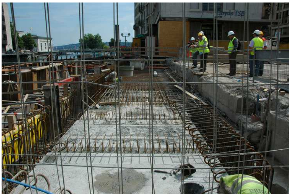
Le pont du Rhône à Bel-Air est remplacé par un nouveau pont dans le cadre de la nouvelle ligne de tram vers Bernex (Foto Martin Bosshard).
