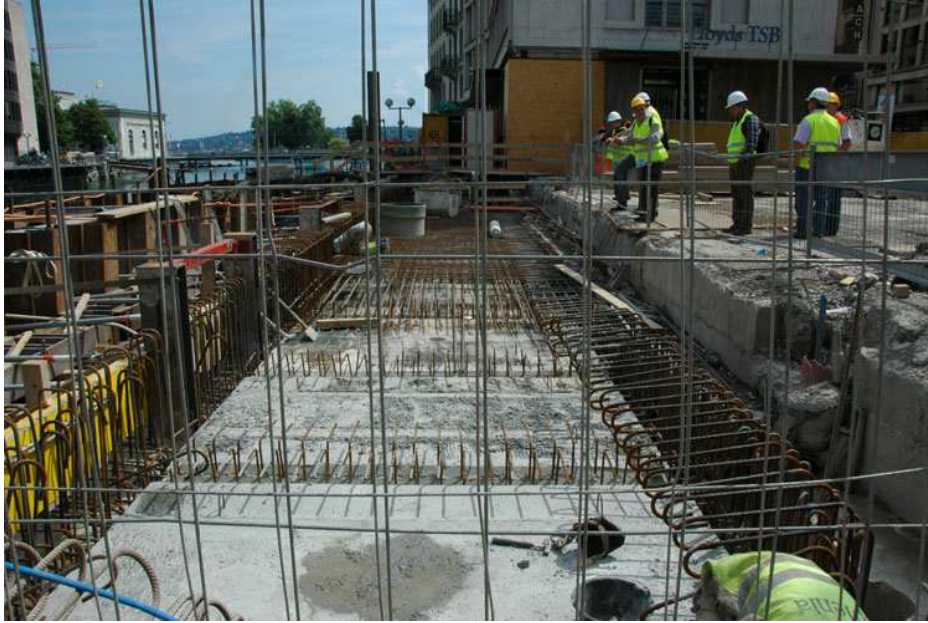
Die Rhône-Brücke bei der Place de Bel-Air wird im Zusammenhang mit der Tramverlängerung nach Bernex neu gebaut (Foto Martin Bosshard).
