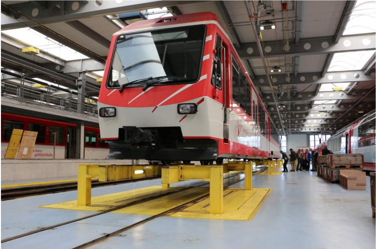
Die neue Hubanlage der MGB für Komet-Triebzüge in der Instandhaltungsanlage Glisergrund.
