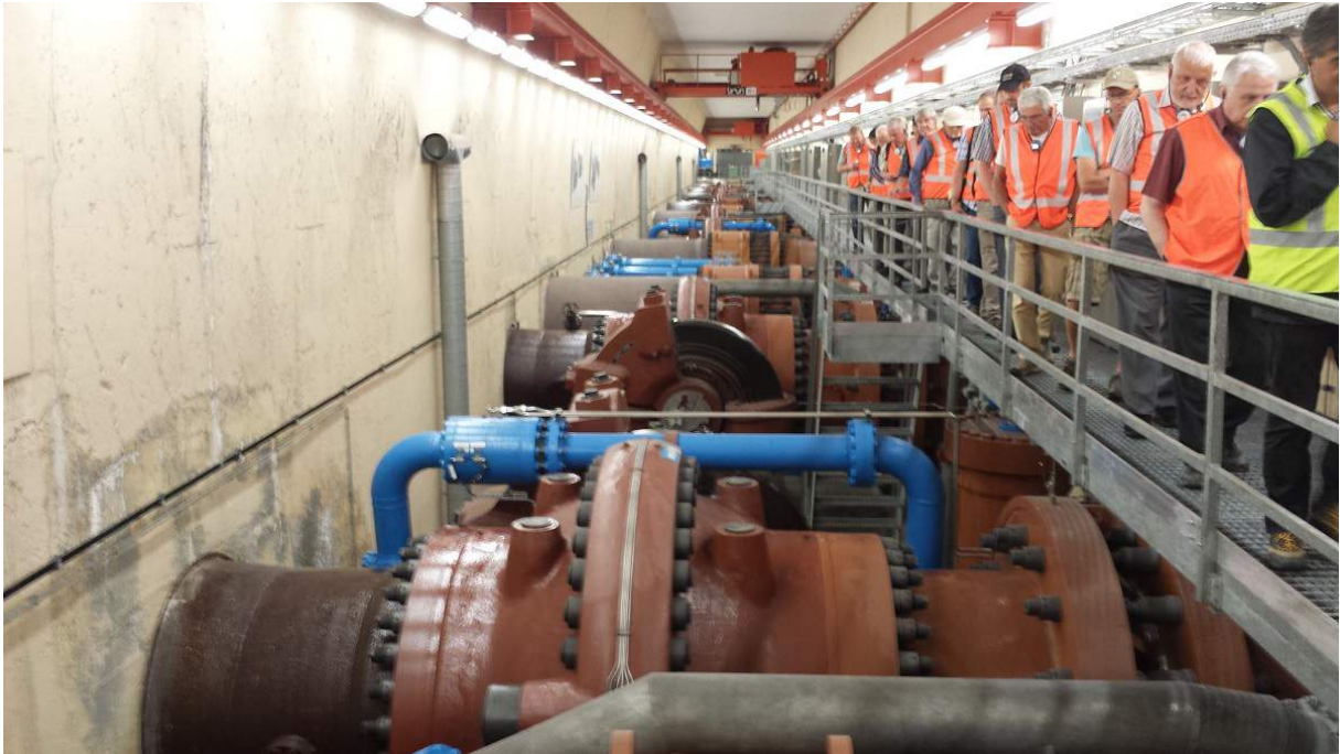
La caverne souterraine de la centrale électrique Grimsel 2 avec les conduits des quatre groupes de machines qui travaillent en génératrice ou en pompage. Il s'agit de la centrale électrique la plus moderne parmi les 9 centrales des KWO.
