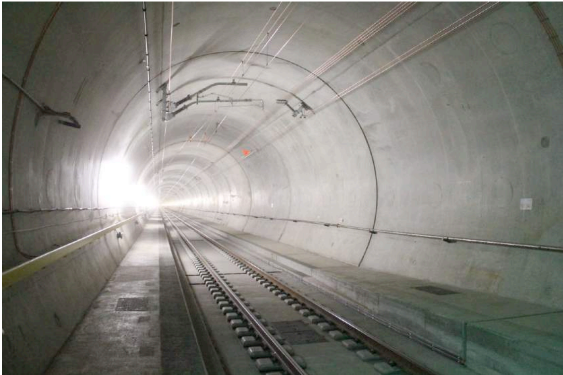
Blick in die Tunnelröhre mit verlegter fester Fahrbahn und fertiggestellter Fahrleitungsanlage.
