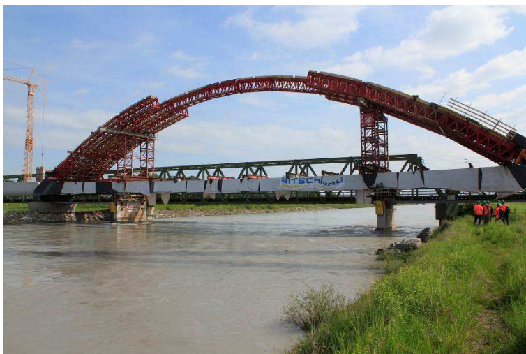
Le nouveau pont sur le Rhin en construction. Il sera nettement plus haut, afin de ne plus faire barrage lors de crues. (Foto Th. Stolz).
