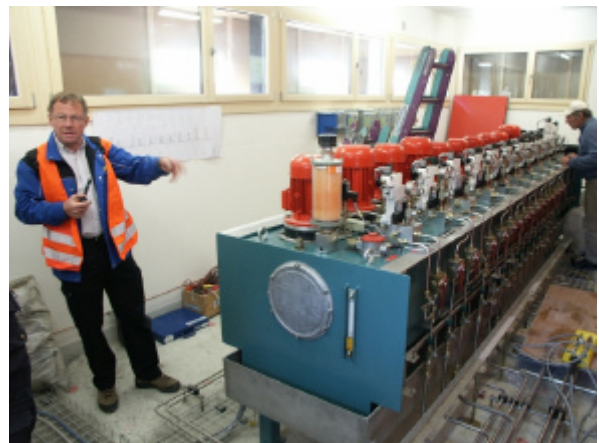
Hans Schlunegger erklärt einen Technikraum der Wasserfassung des Kraftwerks Burglauenen (Foto P. Moser)
